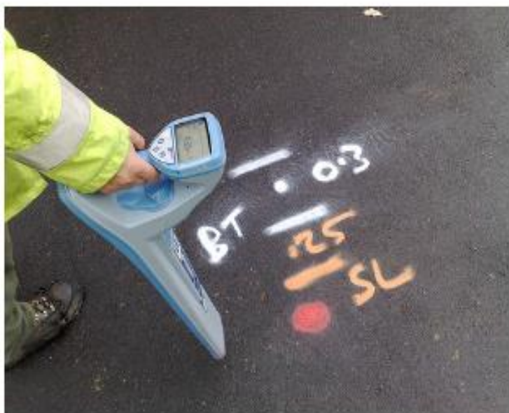
Marquage au sol
